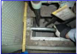
変圧器内部配管
